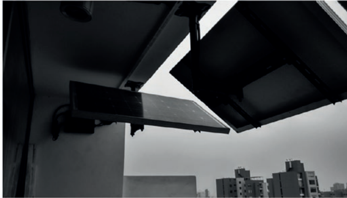
Sistemas de paneles con microinversores en un balcón de Lima. Paneles solares con soportes adaptados para balcones en un edificio de Lima. Se aprecia el microinversor fijado en la pared. Foto: R. Valdivia, 2017
